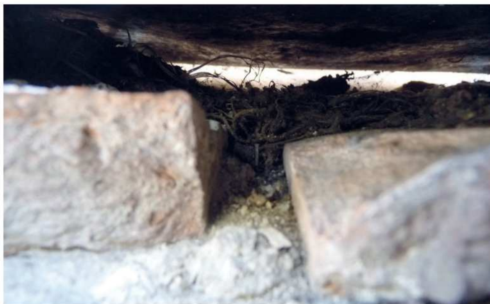
Fot. 66. ... pod tą znajdowało się gniazdo wróbli, które później zajęte zostało przez jerzyki. Na ceglach nie powstają ślady ogona i skrzydeł (DZ)
