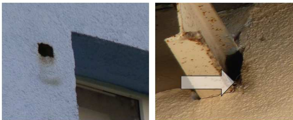
Fot. 34. Ślady po ogonach powstają dosyć szybko na powierzchniach otynkowanych. Na zdjęciu po prawej widoczny ślad pozostawiony przez ptaki w wyniku ocierania się bokiem ciała (DZ)
