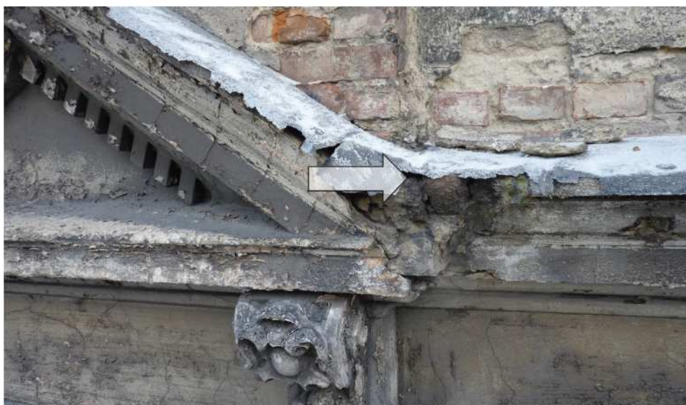
Fot. 65. Zwracać uwagę należy też na obróbki blacharskie... (DZ)
