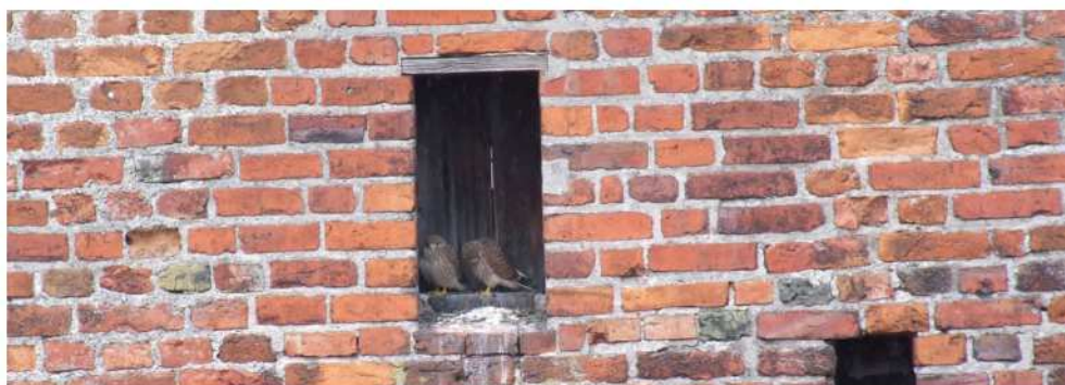
Fot. 88. Pustułki przebywające w niszy w ścianie budynku (MB)
