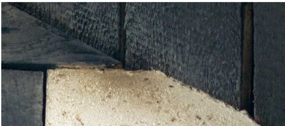
Fot. 71. Pod szczeliną stanowiącą wlot do kolonii dobrze widoczne wytłuszczenie pozostawione przez futro przemieszczających się tędy nietoperzy (DZ)
