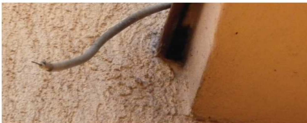
Fot. 79. Ciemna plama na styku balkonu i elewacji to szczelina nie większa niż 2cm, która jedynie z niedokładności robotników wykonujących termomodernizację nie została zasłonięta, umożliwiając nietoperzom nadal korzystać z tego miejsca (DZ)
