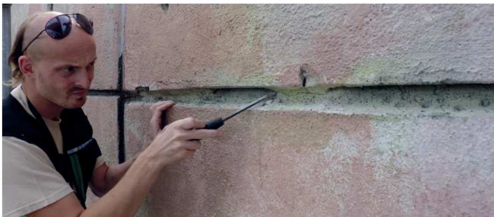
Fot. 77. Odchody nietoperzy są bardzo lekkie, bardzo szybko wysychają i są zwiewane przez wiatr, dlatego chcąc upewnić się, czy ich nie ma należy usunąć nieco spoiwa, aby odsłonić odchody, które mogły się nad nim zgromadzić (DZ)
