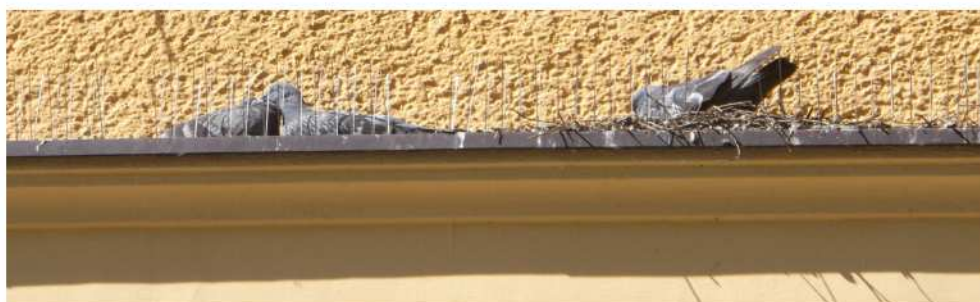
Fot. 127. Gołębie miejskie gniazdujące pomiędzy kolcami zamontowanymi na budynku Starostwa Powiatowego w Białogardzie, woj. zachodniopomorskie (DZ)
