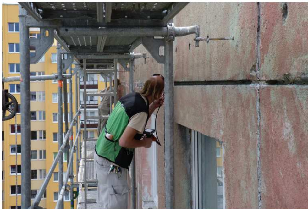
Fot. 97. Przeglądanie obiektu endoskopem z rusztowań. W razie odnalezienia lęgów ptaków lub kryjówek nietoperzy należy zmodyfikować harmonogram prac, co może oznaczać dodatkowe koszty dla wykonawcy (DZ)
