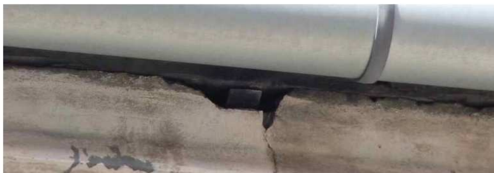
Fot. 50. Ta niewielka szczelina prowadziła do gniazda jerzyków. Pomimo jasnego odcienia elewacji ślady pod szczeliną nie powstały (DZ)
