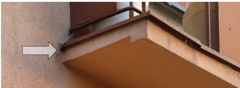
Fot. 78. W tym budynku na styku podłogi jednego z balkonów i ściany, pod obróbką blacharską znajduje się niemal niezauważalne wejście do kolonii rozrodczej karlików malutkich (DZ)
