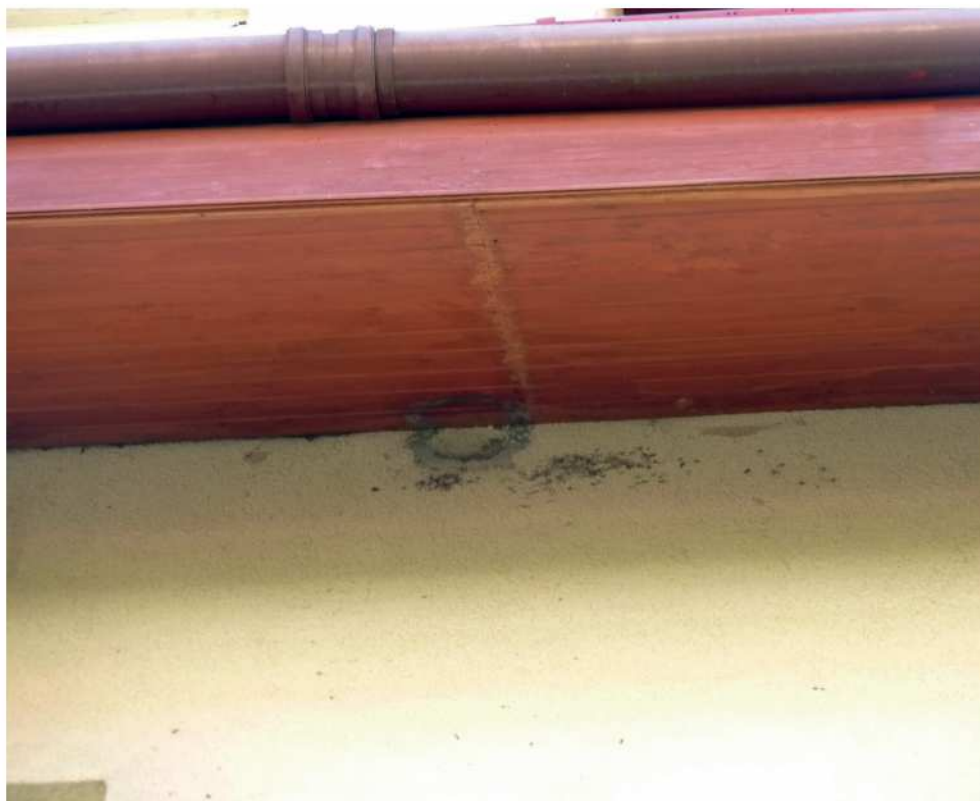
Fot. 98. Ślady po gniazdach oknówek, które wykorzystywały ten budynek w przeszłości i mogą jeszcze do niego powrócić. Należy to uwzględnić przy planowaniu kompensacji (DZ)
