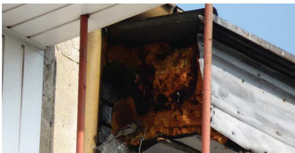
Fot. 51. Uszkodzona boczna część gzymsu umożliwiła gniazdowanie w jego wnętrzu wróblem oraz jerzykom (DZ)
