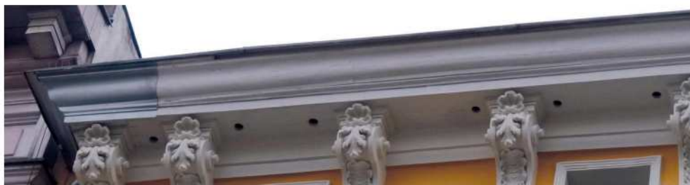
Fot. 101. W gzymsie tej kamienicy gniazdowały jerzyki dostając się do wnętrza przez szczeliny w spodniej części. Po remoncie w miejscach pierwotnych wejść do gniazd wywiercono otwory o średnicy 5 cm (DZ)
