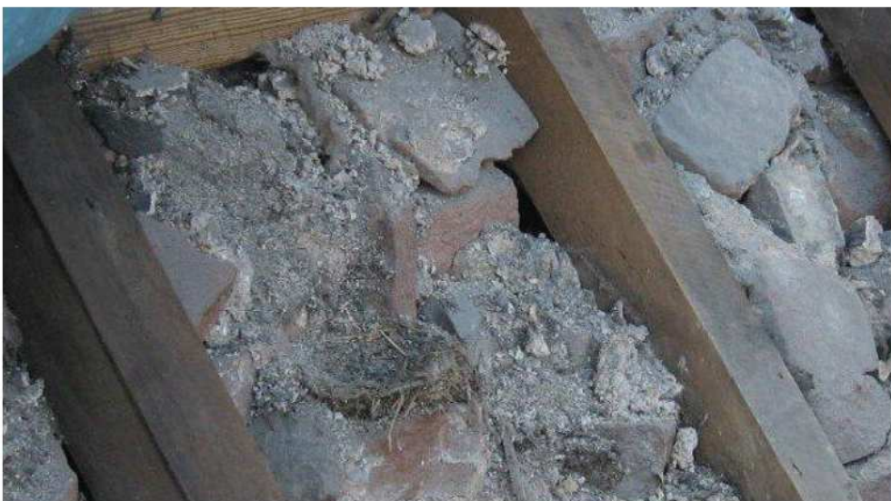
Fot. 40. Gniazdo jerzyka znalezione podczas rozbiórki dachu. Na tym przykładzie widać jak niewiele miejsca potrzeba tym ptakom do odbywania lęgów (TH)
