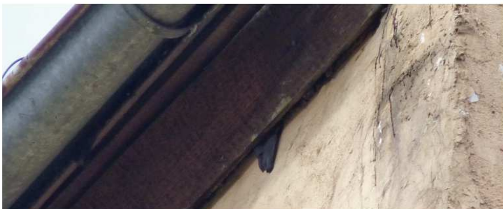
Fot. 41. Jerzyk wchodzący do gniazda za drewnianym obiciem szczytu elewacji (DZ)
