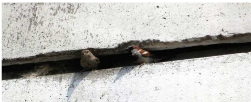
Fot. 38. Wróble gniazdujące w szczelinie dylatacyjnej (AT)
