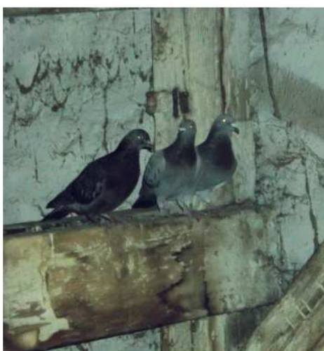
Fot. 68. Gołębie miejskie zasiedlające strych (DZ)
