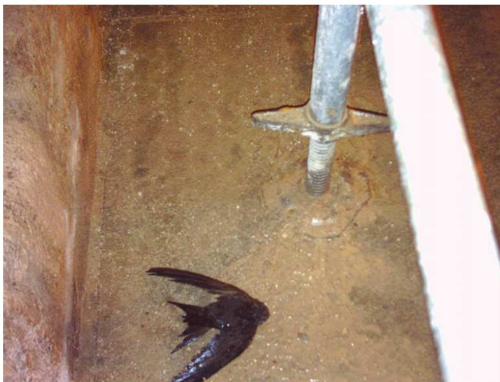
Fot. 86. Po powrocie z zimowiska ten jerzyk tak uporczywie próbował dostać się do pierwotnie zajmowanego miejsca gniazdowania zamurowanego w trakcie prac termomodernizacyjnych, aż padł z wyczerpania (JS)
