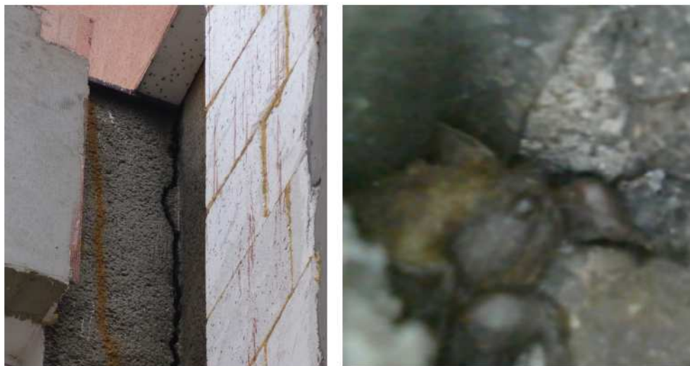
Fot. 94. Prace termomodernizacyjne tego budynku musiały zostać wstrzymane na 6 miesięcy okresu zimowego, ze względu na borowce wielkie gromadzące się na zimowisko w szczelinie dylatacyjnej (DZ)
