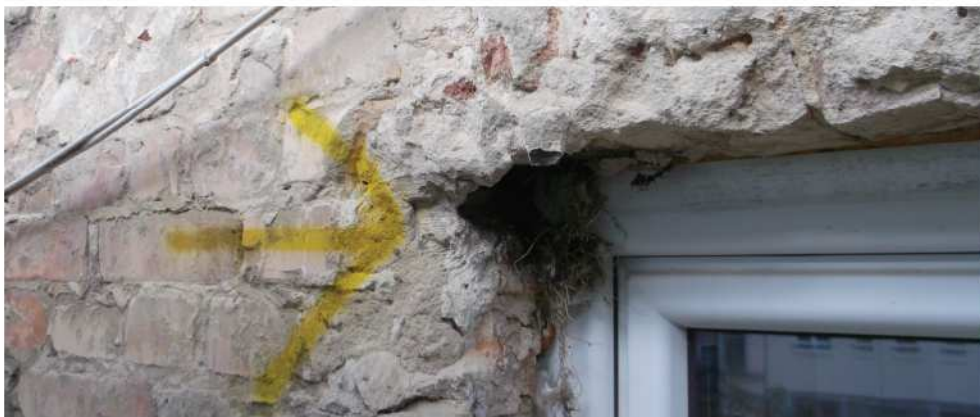
Fot. 64. Na tej fotografii widać materiał gniazdowy naniesiony przez wróbli do szczeliny w rogu okna (DZ)
