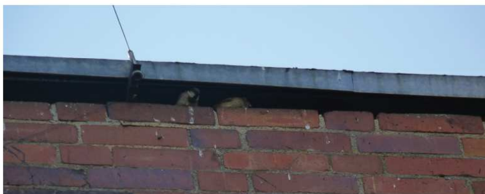
Fot. 52. Pod obróbką blacharską dachu płaskiego, pomimo pozornie wysokich temperatur tam panujących, miejsce na gniazdo wybrały wróble. Podobne miejsca mogą być zajmowane przez kolonie rozrodcze nietoperzy (DZ)
