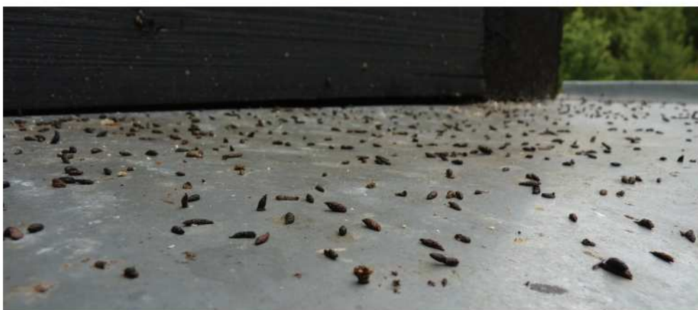
Fot. 72. Pod wejściem do kolonii liczącej setki osobników na ziemi oraz na elewacji gromadzi się sporo odchodów (DZ)
