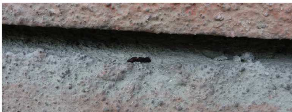
Fot. 76. Kiedy nietoperze zajmują kryjówkę dzienną w bloku wielkopłytkowym, ich odchody mogą opadać poniżej i gromadzić się na łączeniu płyt (DZ)
